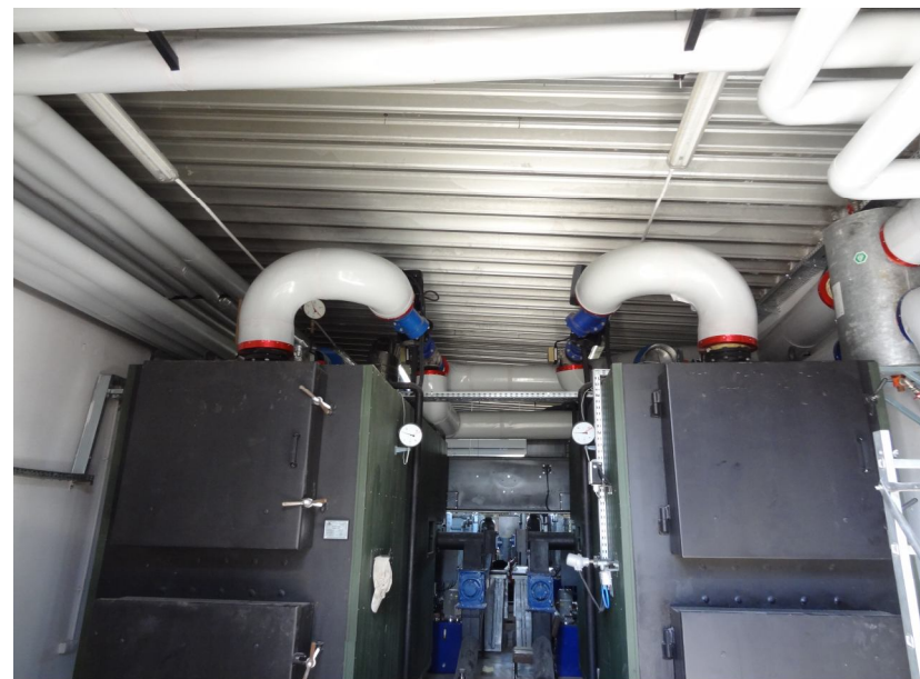
Kotły na biomasę
